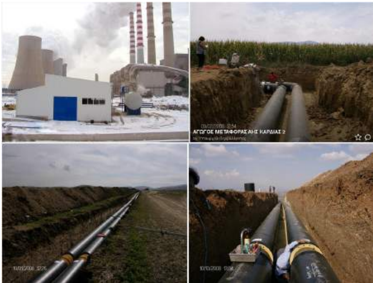
Εικόνα 1.1: Τηλεθέρμανση Πτολεμαΐδας - Σύνδεση με τον ΑΗΣ Καρδιάς 1
